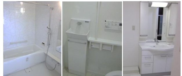
ホワイトで統一された水廻りの設備機器。(左からシステムバス・トイレの手洗い器付収納等・洗面化粧台)
